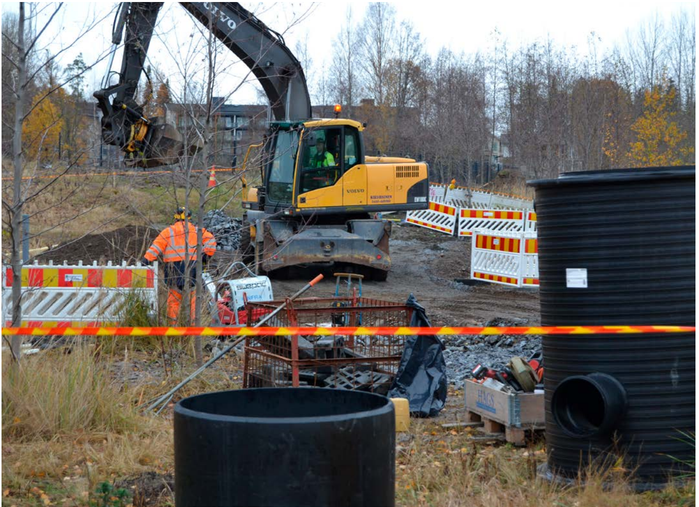
Huoltotoimia Hiedanrannan biosuodattimen automaattisella veden laadun mittausasemalla.
